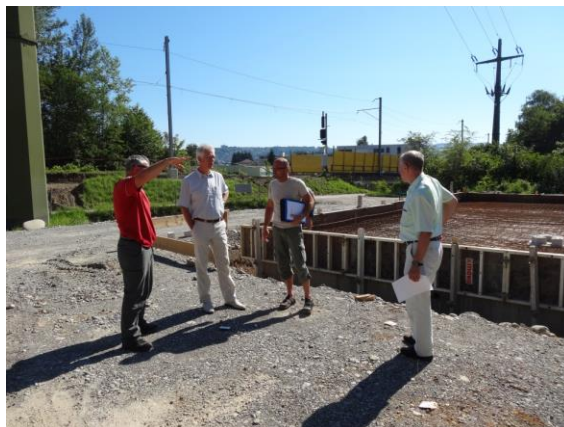
Abb. 5: Besprechung auf der Baustelle des neuen Forstwerkhofs in Bremgarten; die Bodenplatte entsteht.
