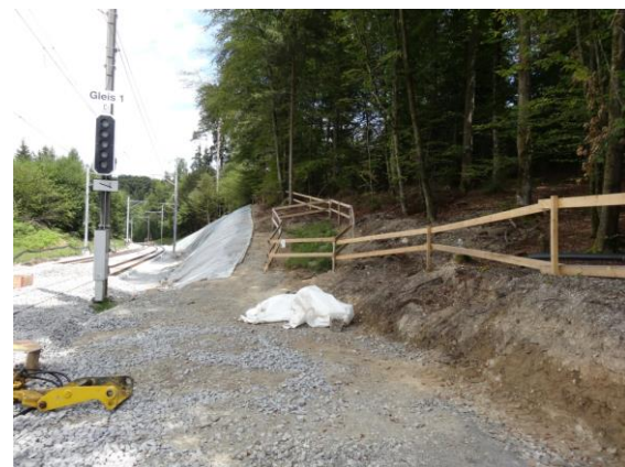
Abb 4: ... musste verlegt werden, samt dem ganzen dazugehörigen Erdreich
